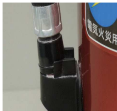
× 消火薬剤の漏れ
