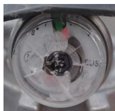
× 指示圧力計の損傷
